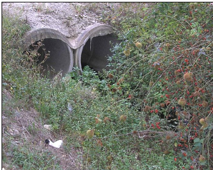
Slika 20: Pogled na zaraščeno strugo pri dvocevnem propustu (Prebil, 2009)
