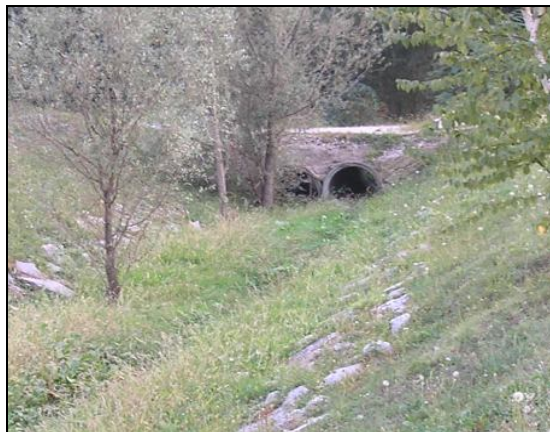
Slika 58: Nujna odstranitev cevne propusta (Prebil, 2009)
