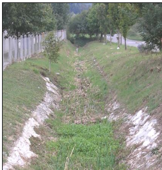
Slika 30: Pogled na zavarovano strugo s parkovno zasaditvijo in odmikom ograje od roba brežine (Prebil, 2009)
