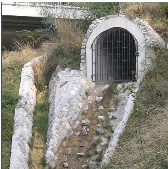
Slika 18: Odvodna cev pod predorom Solkanske obvoznice (Prebil, 2009)
