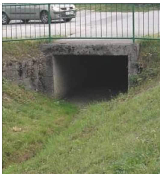
Slika 31: Vtok v poddimenzionirani kanaliziran odsek na vhod v Final (Prebil, 2009)
