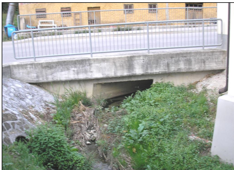
Slika 65: Propusta pod staro vpadnico (Prebil, 2009)
