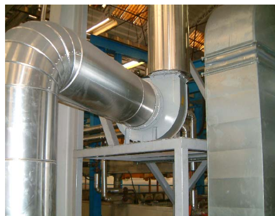
Slika 6: Ventilator in cevovod za odsesavanje zraka iz ohlajevalne komore
